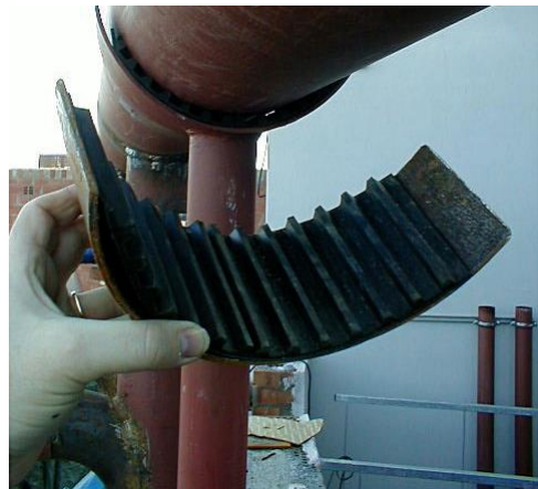
En puntales y cunas para apoyos en peines de tuberías
