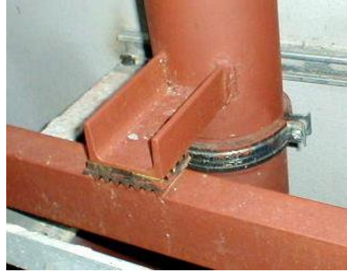
En apoyos de fijaciones de tuberías
