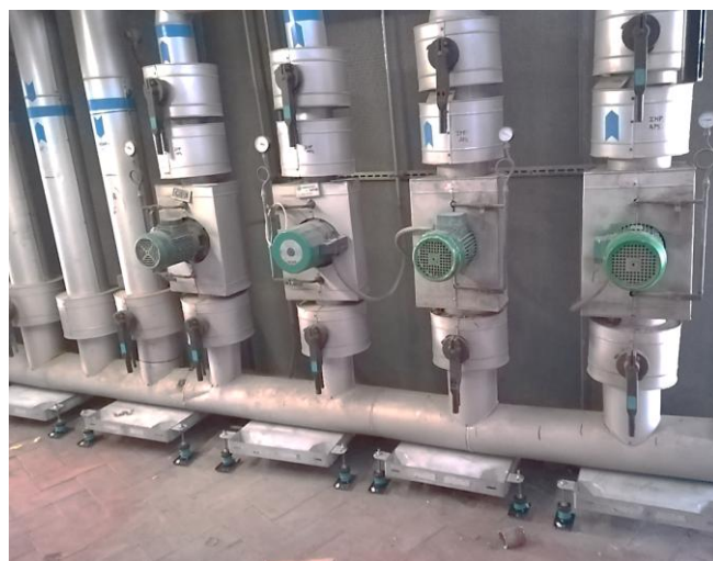
Patologías vibroacústicas: resultado final
