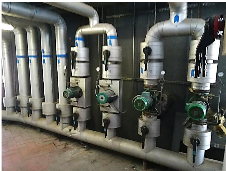
Patologías vibroacústicas: en tuberías: Inicio
